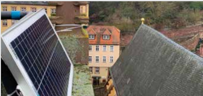
Stromversorgung über Solar-Panel
