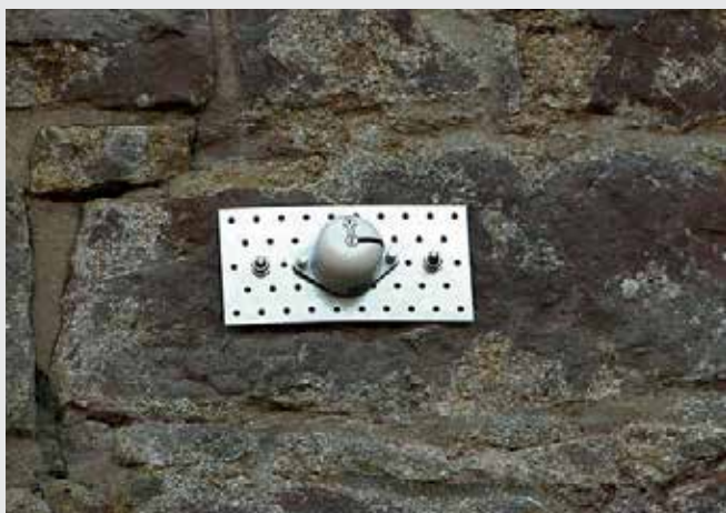
3D-Monitoring Sensoren überwachen die Bewegung der Mauer und übermitteln die Messwerte per Mobilfunk an einen Server.
