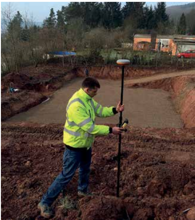
Volumenaufnahme eines Hügels und des dazugehörigen Aushubs durch ein Ingenieur- und Vermessungsbüro
